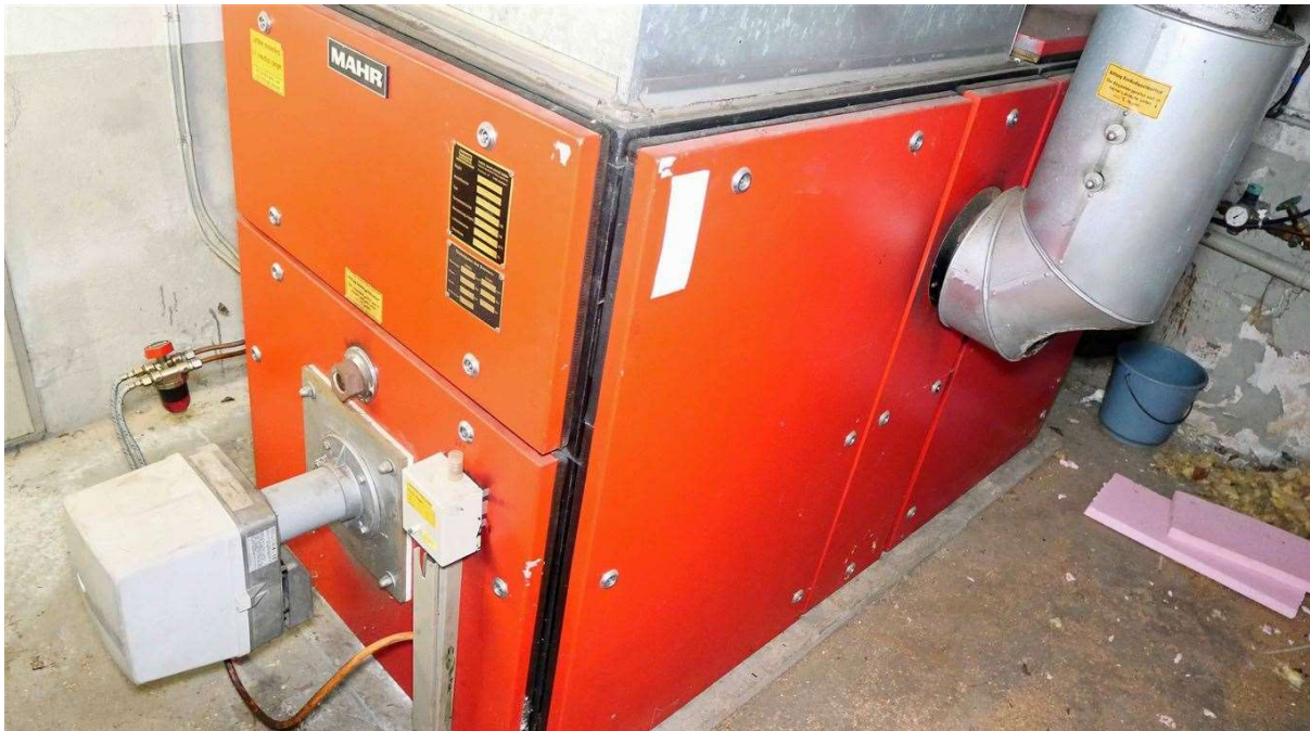
Ölheizung mit Warmluft-Gebläse
