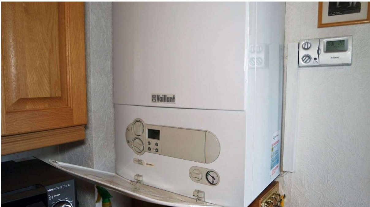
Brennwert- Erdgas-Zentralheizung Bj. 2003
