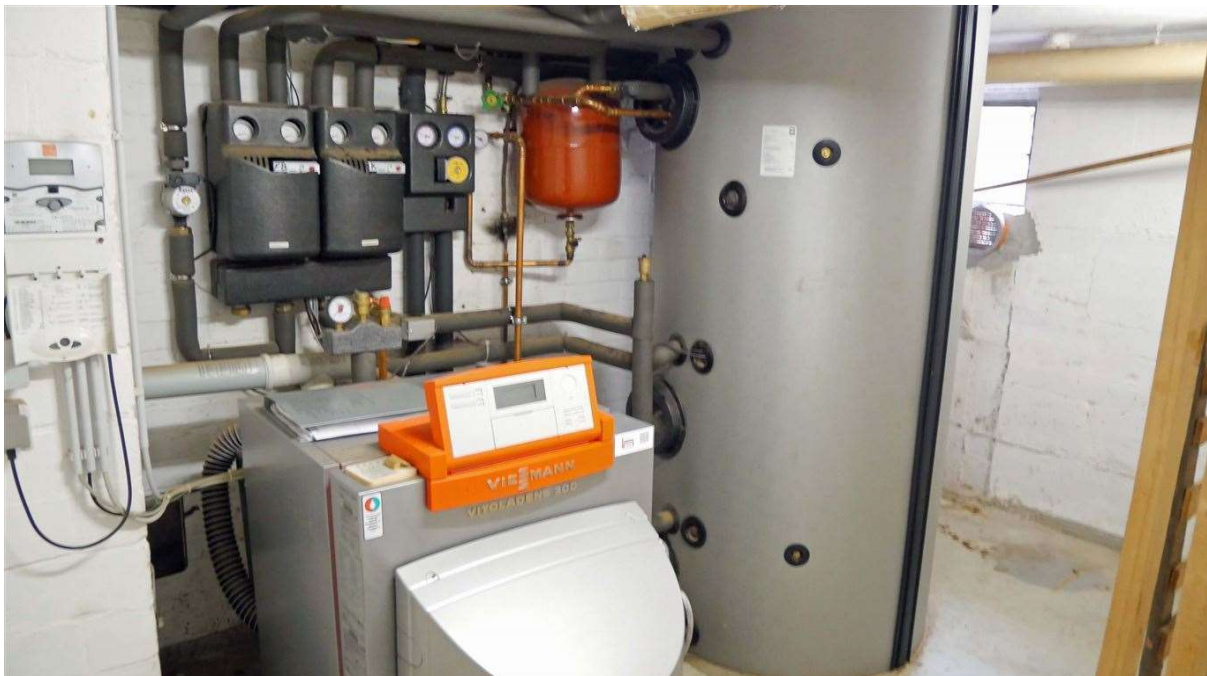
moderne Öl-Brennwert-Heizung, Baujahr 2008 mit Solar
