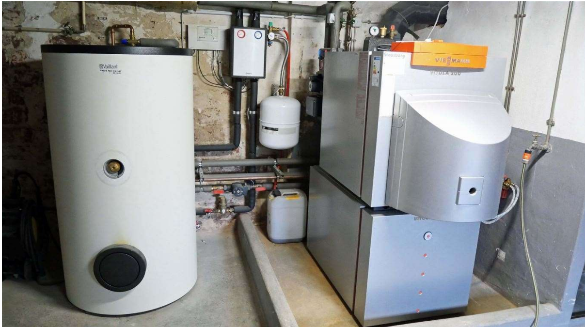
Öl-Zentralheizung Baujahr 2003 mit Solarunterstützung Baujahr 2010
